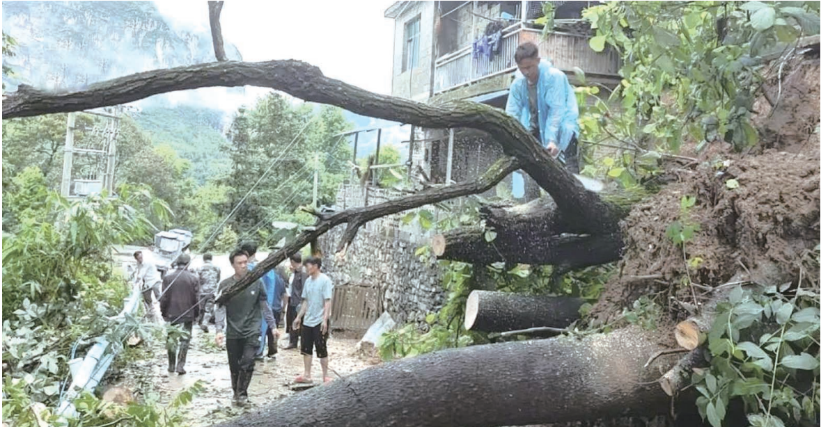
工作人员清理路面倒塌的树木。
